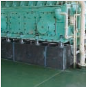
Gasmotor auf Betonfundament
